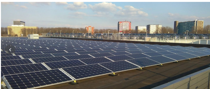
Zonnepanelen op een dak van Akerpoort. Op het BCO zijn nu 1.740 zonnepanelen geplaatst.
